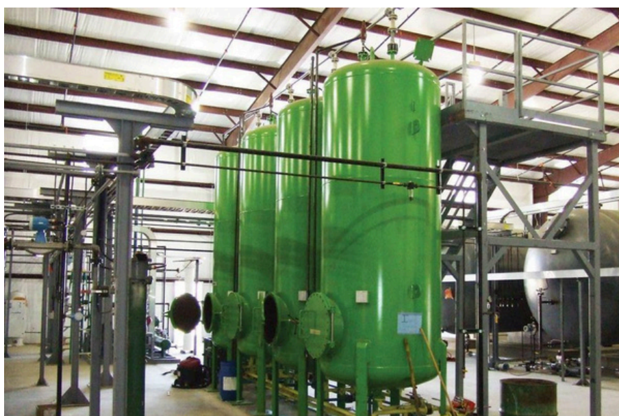
Retrofit de Sistema de Troca Iônica
